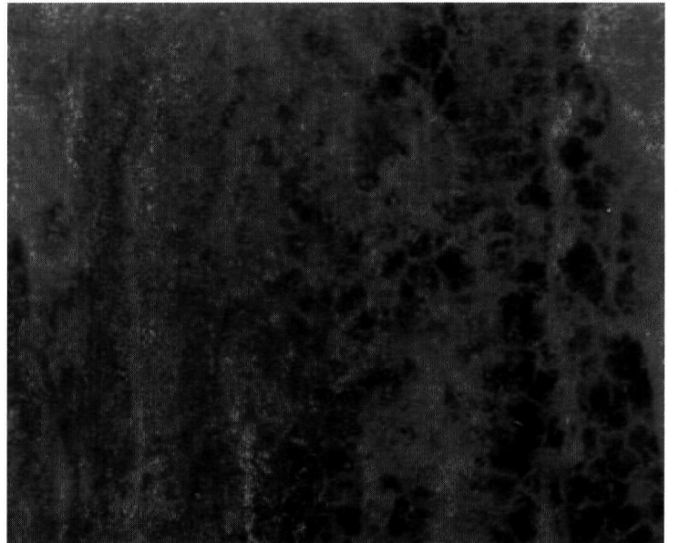
Şekil 3. Beton yüzeyindeki kuruma renk bozuklukları
