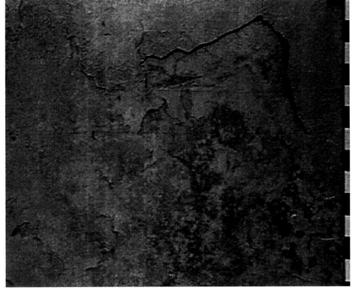
Şekil 7. Beton yüzeyinde meydana gelen soyulma
