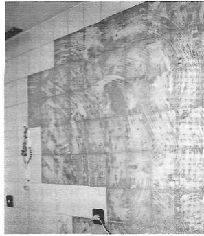
Resim 2. Seramik duvar karolarında uygulama hatasından dolayı meydana gelen dökülmeler
