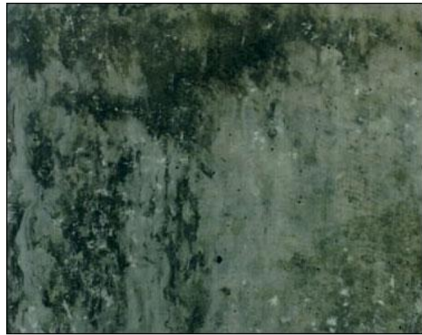
Şekil 1. Kalıp yağının yanlış kullanımından kaynaklanan yüzey kusuru.
