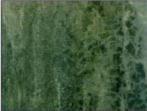
Şekil 3. Beton yüzeyindeki kuruma renk bozuklukları
