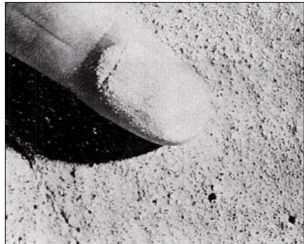
Şekil 2. Beton yüzeyinde meydana gelen tozlanma
