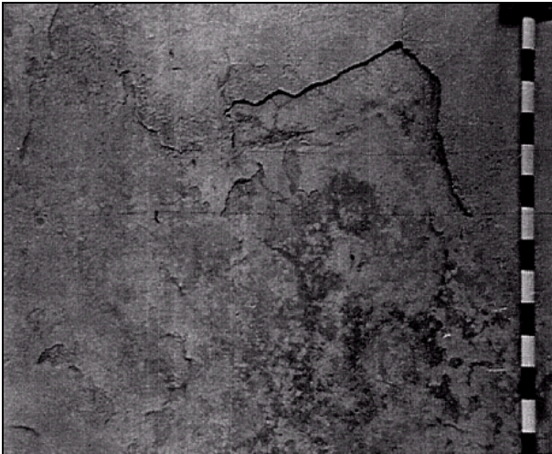
Şekil 7. Beton yüzeyinde meydana gelen soyulma
