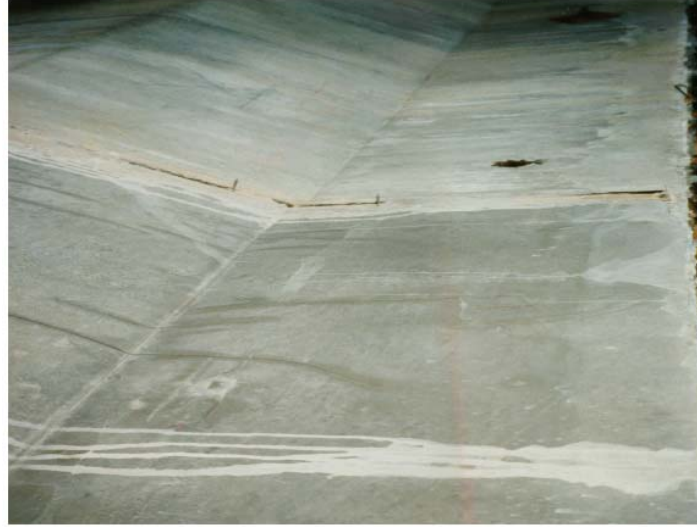
Resim 2.6 Konfederasyon köprüsünde buz kalkanlarında tekstil astarlı kalıp kullanılarak dökülmüş pürüzsüz beton yüzeyi
