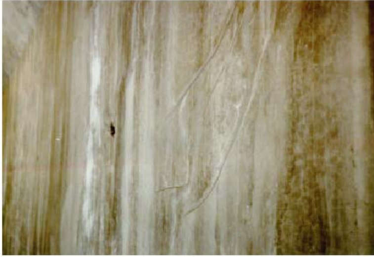
Resim 2.2 Gevşek montajdan kaynaklanan astar katlanmasının beton yüzeyine yansıması
