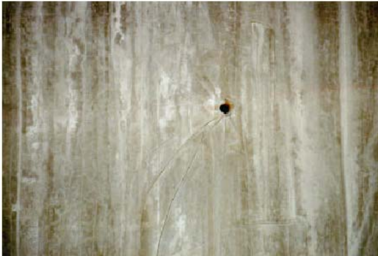
Resim 2.3 Kalıp gergi deliği boşluğu etrafında gevşek astar katlanmasının beton yüzeyine yansıması
